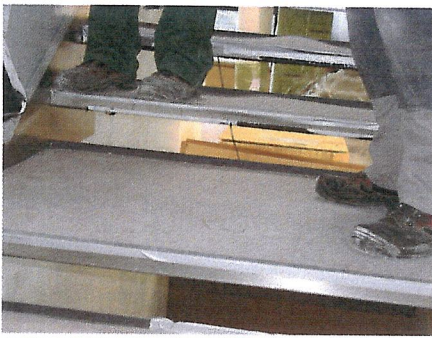
Abb. 3: Gegen Verschieben gesicherte, abgedeckte Treppenstufen
