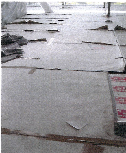
Abb. 6: Verklebte Stöße, die sich im Laufe der Bauzeit gelöst haben und teilweise neu verklebt wurden. Gut zu sehen sind auch hochgeklappte Stöße, die Stolperstellen bilden
