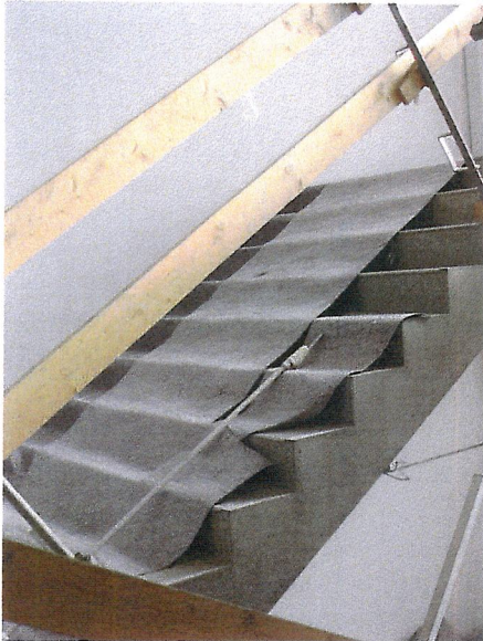
Abb. 2: Unzureichende Abdeckung einer Treppe mit einem Malerabdeckvlies
