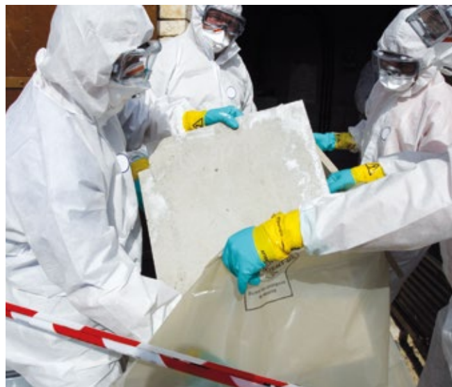
Trotz Asbestverbot können auch heute noch Beschäftigte im Rahmen von Sanierungsarbeiten mit Asbest in Kontakt kommen.
